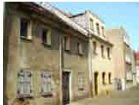
Entengasse 7 Leerstand Wohnbebauung, Sanierungsbedarf
