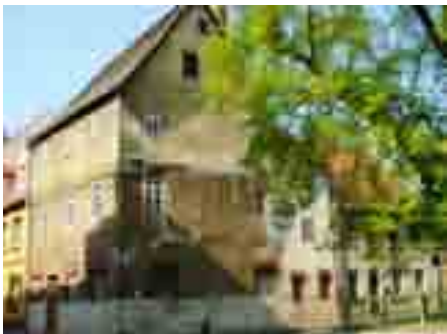
Erzenstraße 14, denkmalgeschütztes Eckgebäude Sanierungsbedarf
