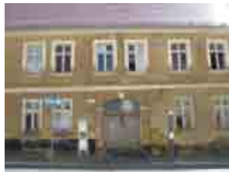
Holzweißigstraße 12 weiterer Sanierungsbedarf Fassade und Fenster
