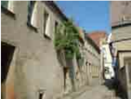
Neustraße ruinöse Bausubstanz
